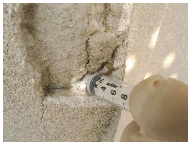
Fig. 21 – Consolidação da falta de aderência da marmorite
