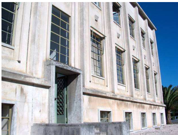
Fig. 8 – Manchas de sujidade e crosta negra
