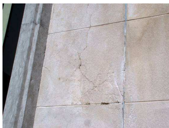
Fig. 13 – Fissuração e perda de coesão
