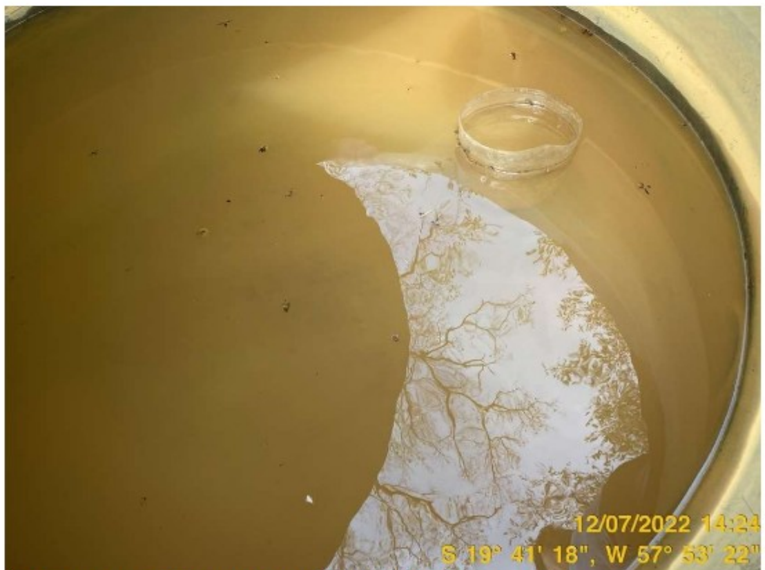
Foto 17: Caixa de Armazenamento de Água para Consumo
