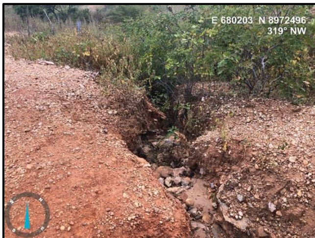
FOTO 6.1.4.7 – Feições erosivas lineares (sulcos) ao longo da estrada que dá acesso o relevo escarpado, nas proximidades da localidade de Baixão do Moises. O fluxo de água pluvial escavou o local provocando o surgimento de ravinamentos.
